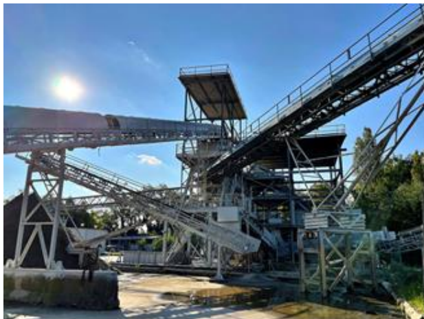
Figura 9 - Dettaglio Impianto di Soil Washing
